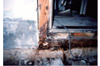
浴室をユニットバスに改装中 シロアリ被害を発見
